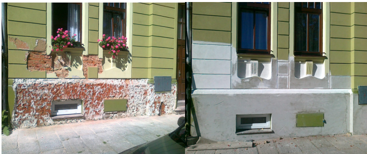
Ukázka sanace: dodatečná hydroizolace tlakově prováděnou infuzní clonou s následnou sanační omítkou.
